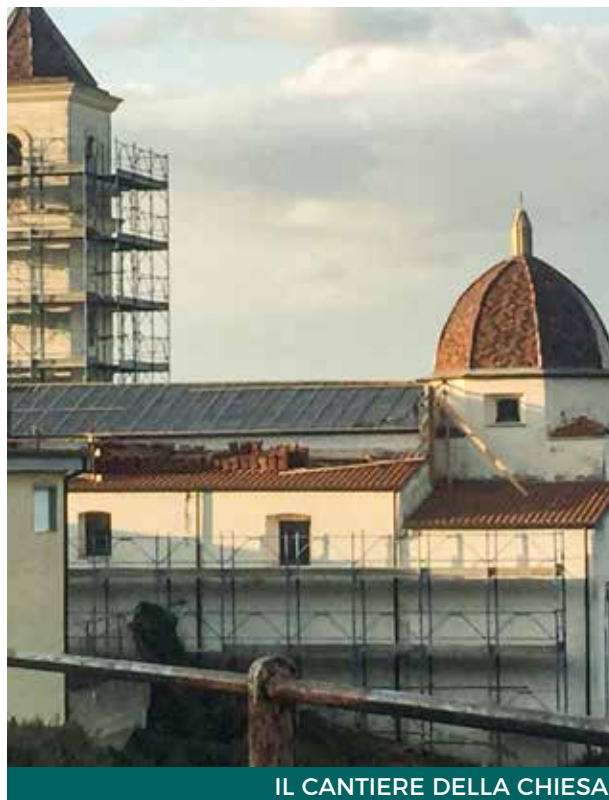
IL TETTO DANNEGGIATO
